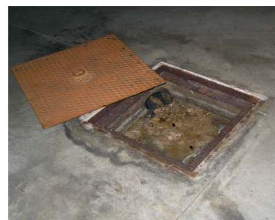
Arqueta de paso defectuosa. Escasa profundidad y ausencia de superficie bruñida y bordes redondeados
